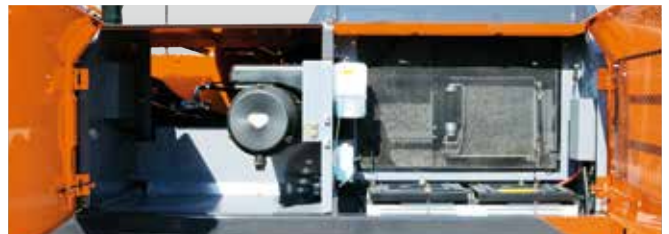
Espace de rangement et radiateurs
